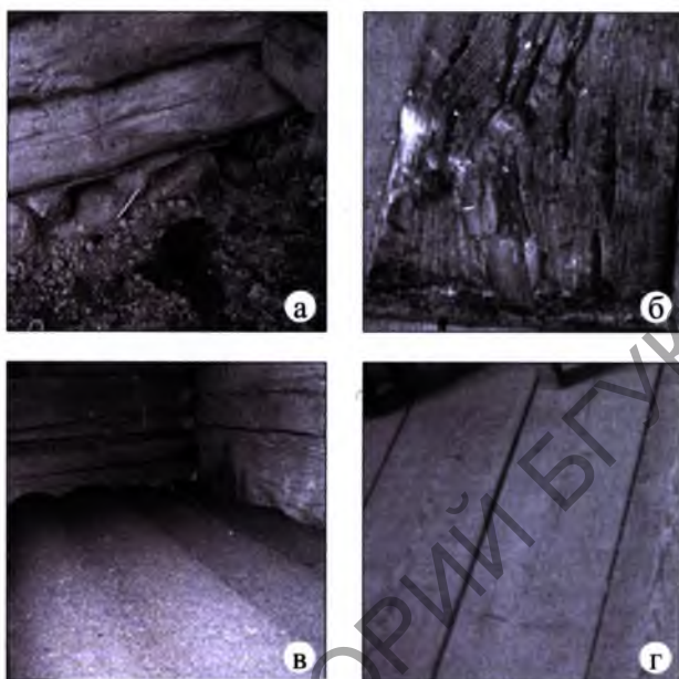
Фото 1. Использование торфяного сорбента для профилактики поражения древесины домовым грибом (памятник «Бракова Слобода» БГМНАБ): а – разрушение фундамента по причине поражения древесины сруба домовым грибом; б – деградированная древесина досок пола, пораженных домовым грибом; в – торфяной сорбент в подпечье памятника «Бракова Слобода»; г – доски пола после проведения натуральных испытаний
